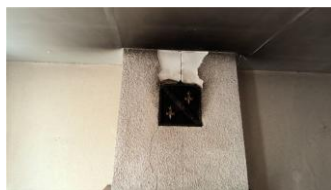
fissures conduit insert
