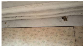
fissures plafonds et haut de murs étage
