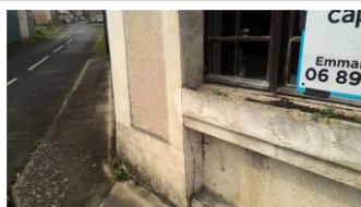
fissures tableau menuiseries
