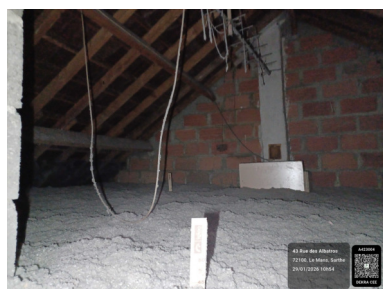
Présence d'un cadre rigide autour du deuxième conduit d'évacuation des fumées.
