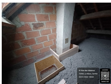
Présence d'un cadre rigide autour du premier conduit d'évacuation des fumées. Présence d'un cadre rigide autour du puits de lumière.
