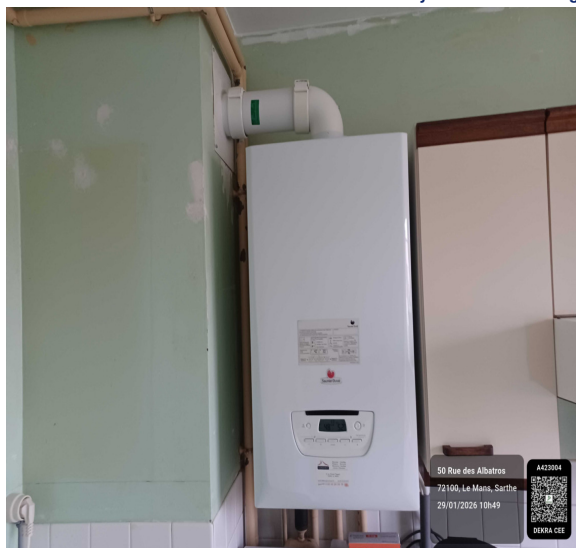
Photo du système de chauffage
