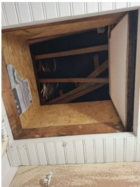
Rehausse de trappe
