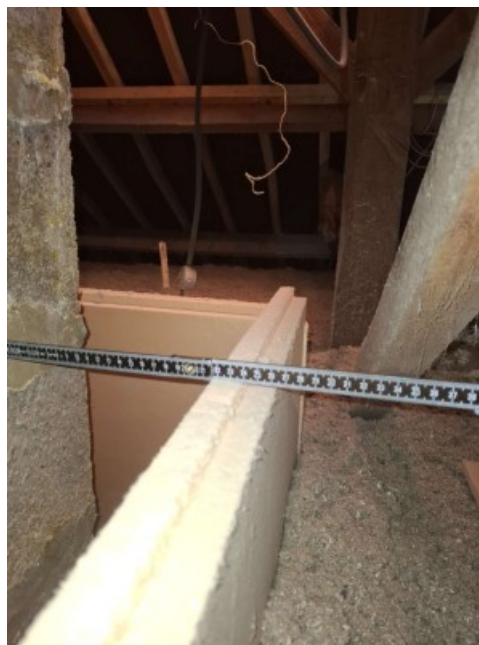
Ecart au feu conduit de fumée 1
